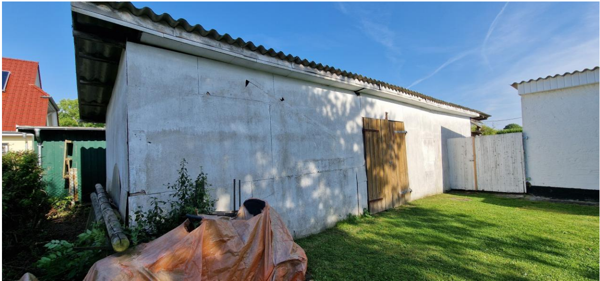
Abbildung 10: Die Asbestplatten eines Schuppens wiesen viele Zugangsmöglichkeiten für Fledermäuse auf.
