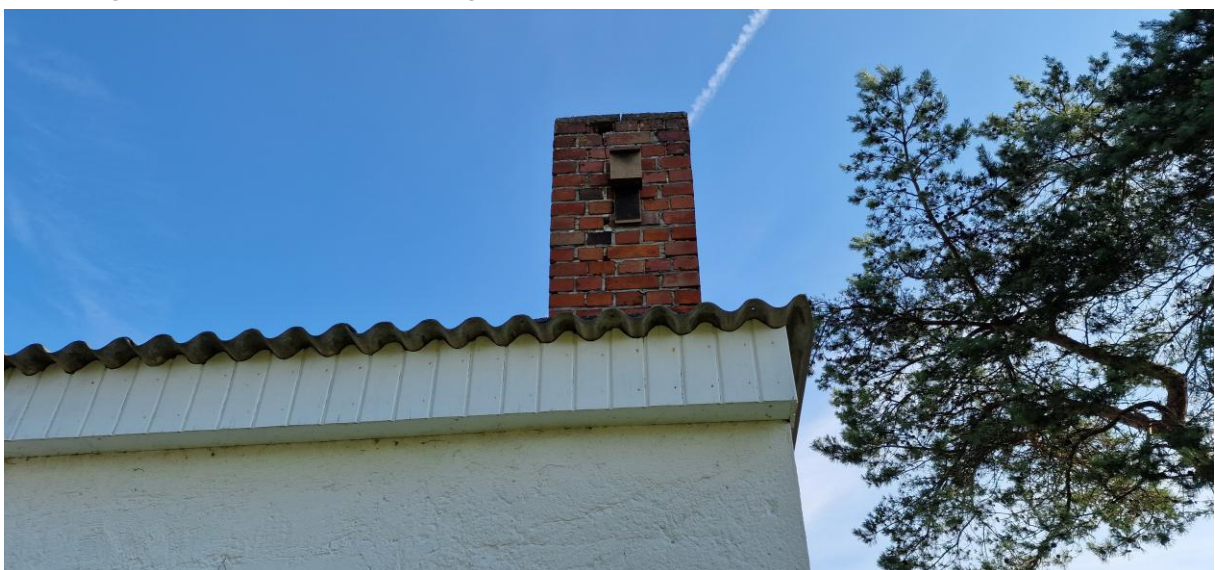
Abbildung 12: Fledermauskasten am Schornstein des Massivbungalows.
