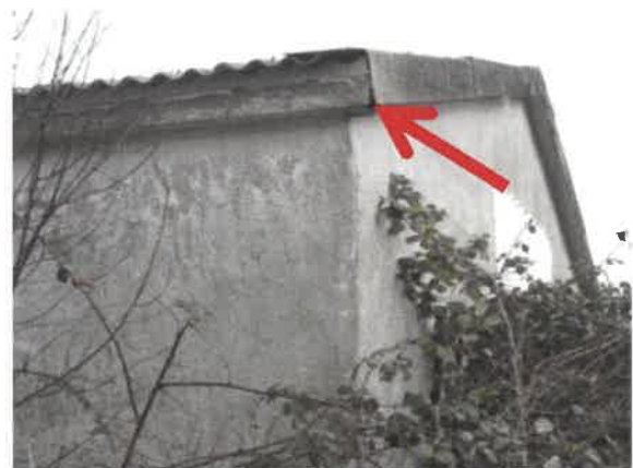
Foto 2: Gebäude 2: wie Gebäude 1, Spalten vorhanden (s. Pfeil)
