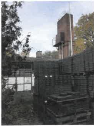
Warmwasseraufbereitung am Schornstein der Heizanlage
