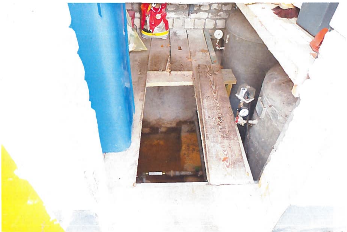
Abbildung 19: Keller im Pumpenhaus B3.
